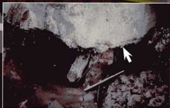
阪神・淡路大震災で折れた埋め立て地の基礎杭（矢印）
